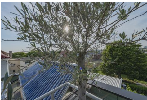
Lignotrend Passivhaus RT_341_Solarthermie
